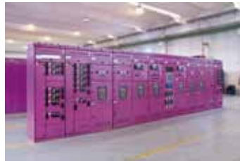
Intelligent PMCC Switchgear
